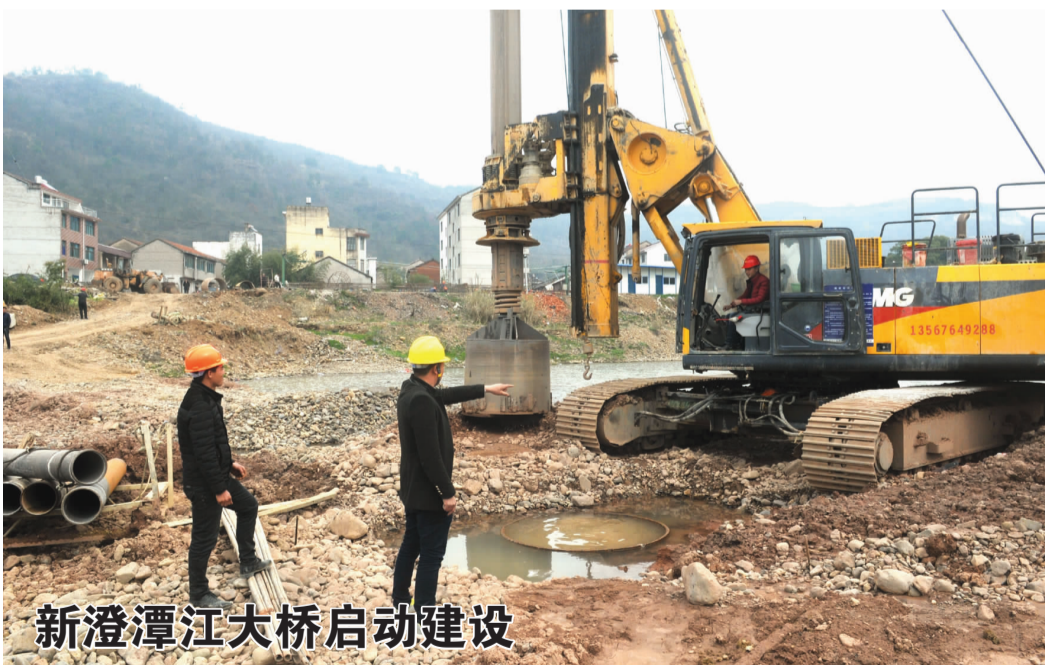
新昌新闻网记者石磊 通讯员陈羽明摄影报道 3月11日,施工单位在澄潭镇社古村旁的澄潭江上打下第一根桩基,标志着新澄潭江大桥启动建设。据介绍,该桥系省重点公路改建项目——嘉兴秀洲至台州路桥公路新昌梅渚至澄潭段改建项目的控制性工程,主跨450米,为预应力砼T梁I级公路桥梁,设计行车速度每小时80公里。
