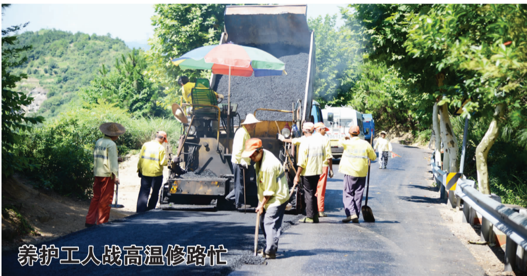
养护工人战高温修路忙 新昌新闻网记者石磊 通讯员俞晨莺摄影报道 夏季高温是浇筑沥青、修补路面的黄金季节。7月22日，在县道澄儒线，10多位公路养护工人顶着烈日正在进行路面大中修工程的沥青摊铺作业。据悉，今年我县公路部门将对41公里农村公路路面实施大中修工程，目前形象进度已达45%。
