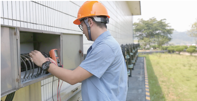
检测水厂仪器设备
