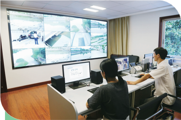
新昌江智慧河道在线监控平台
