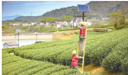
◆ 对茶园电气设备巡检
